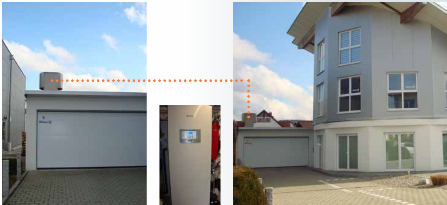
Luftwärmepumpe in einem drehbaren Solarhaus
