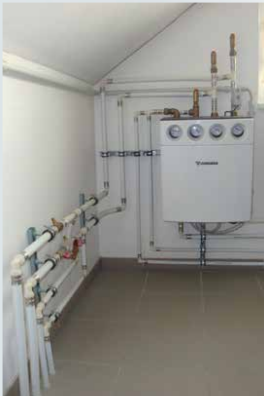
Gas-Therme mit Solar
